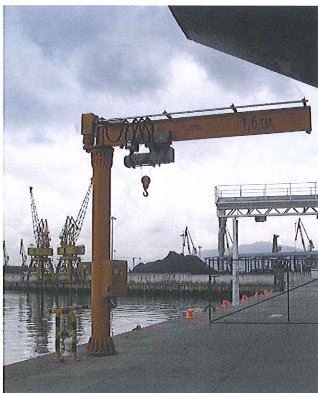
Imagen 2. Grúa Jaso de 1.6 Tm, instalada en el muelle de descarga de la Lonja
