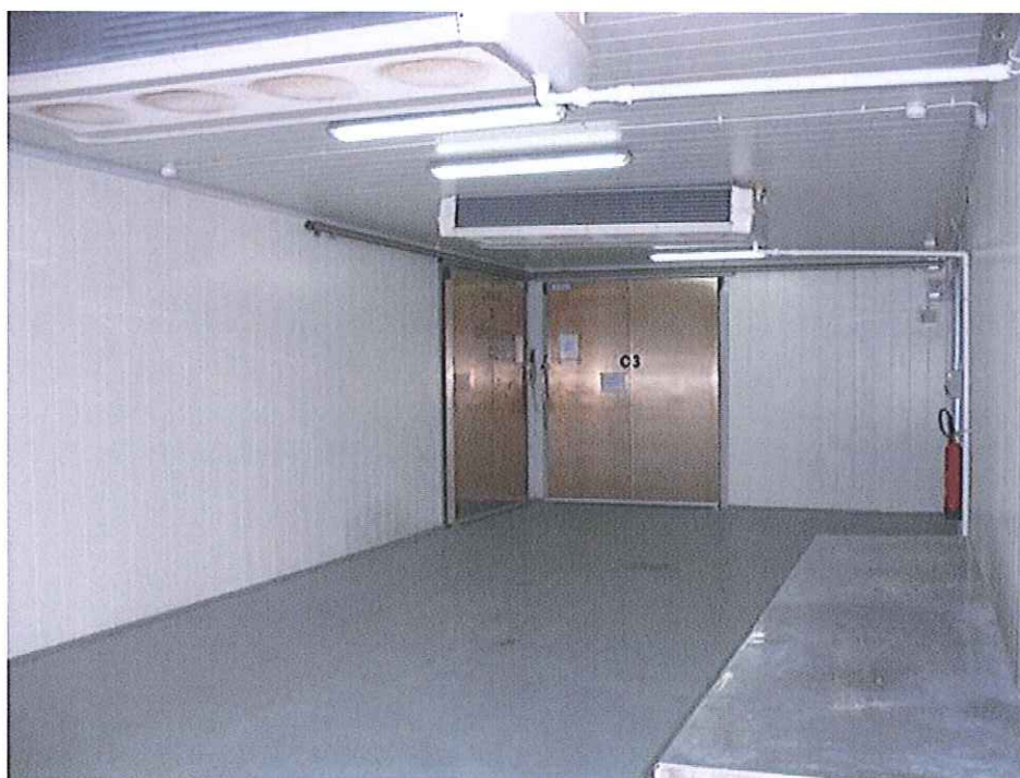
Imagen 8. Interior de las cámaras frigoríficas
